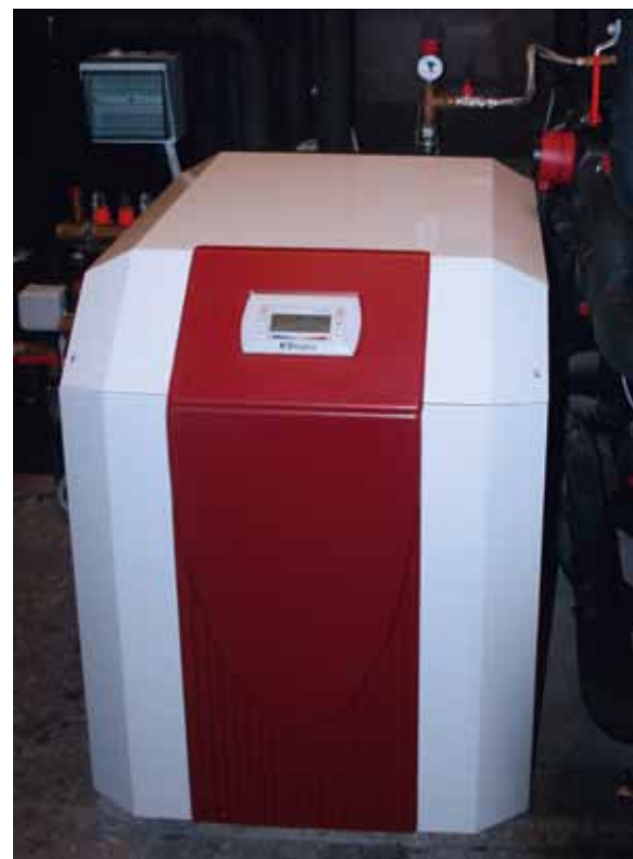
De installatie van deze geothermische SI 18 TU-warmtepomp van Dimplex – in ons land verdeeld door Engels/Thermo Comfort – gebeurde door Renewable Heating Concepts.
